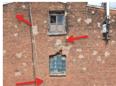
Рисунок 2 – Пример дефектов стен. Дефект кирпичной кладки наружных стен в уровне 5 этажа
