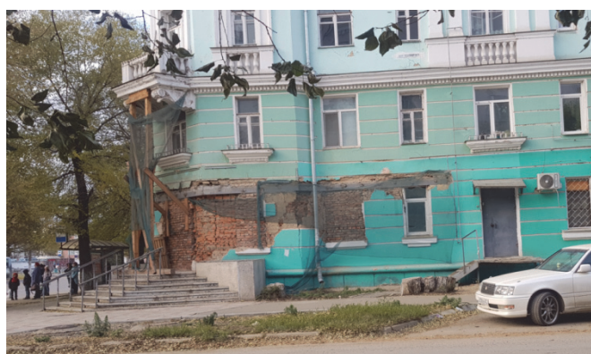
Рисунок 2 - Разрушение эркера жилого дома, расположенного по пр. Мира, 30
