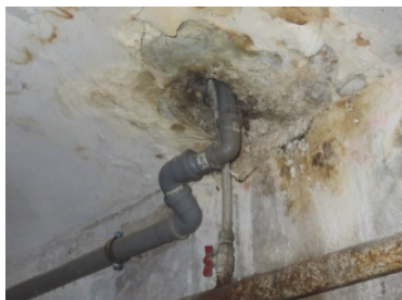
Рисунок 1 – Пример дефекта перекрытий. Низкое качество работ по омоноличиванию технологического отверстия в конструкции перекрытия
